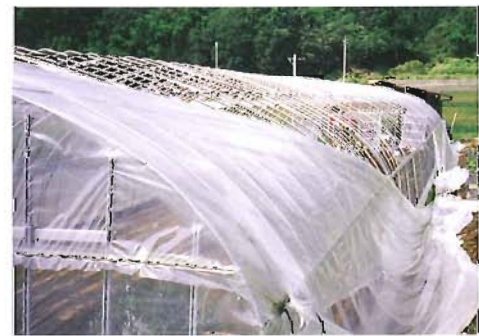
2004年の台風18号で壊れたグリーンハウス。ビニールはほとんど剥がれて骨組みも傾いていた。
